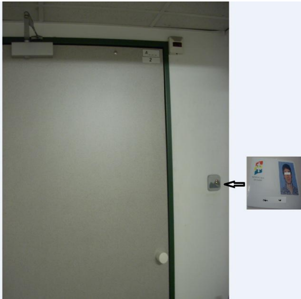
Figure 5: Entrée Porte à accès par badge
