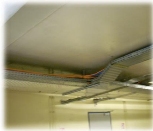
Figure 24: Câbles électriques et leur passage
